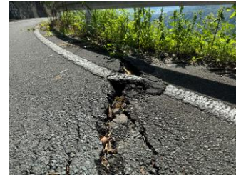
図4 観測点における亀裂(2024/9/19撮影)
